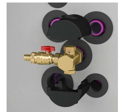
Trinkwasser-Eintritt kalt an Anschluss 9
